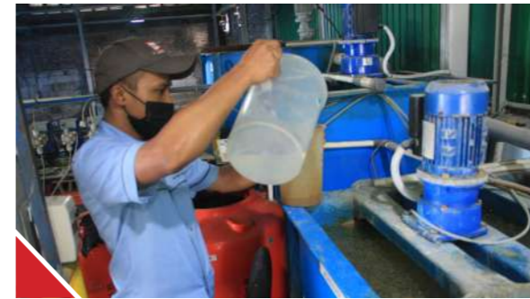
Tahun 2025, Perseroan berhasil menyelesaikan instalasi Instalasi pengolahan Air Limbah (IPAL) yang kini telah beroperasi secara optimal, menunjukkan komitmen terhadap keberlanjutan dan kepatuhan lingkungan.
